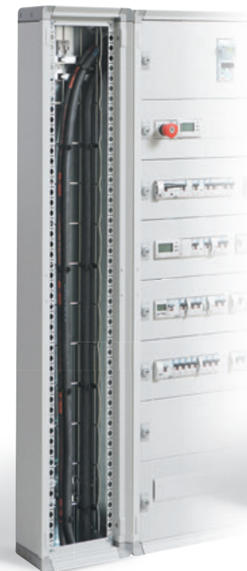
Gaine externe équipée d'un chemin de câbles
