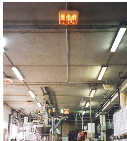
Les IRCFC sont souvent installés dans de grands entrepôts. Ils fournissent une chaleur instantanée et efficace qui les rend rapidement rentables.
