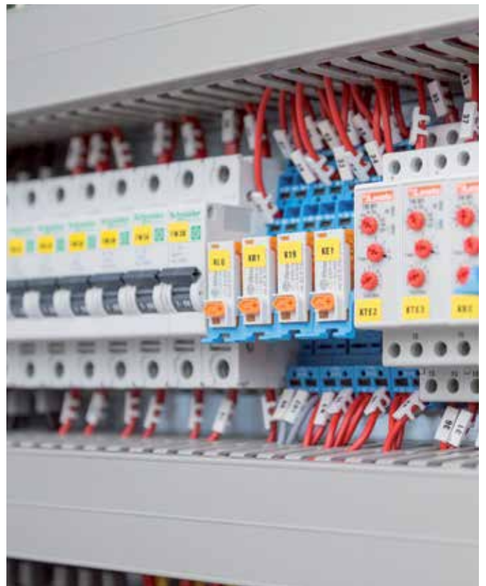
Une installation logique, ordonnée et nette dans l'armoire de commande
