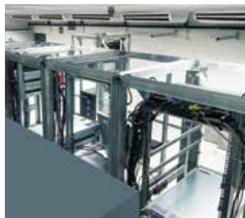
Salles de serveurs
