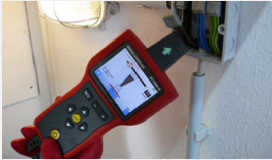
Traçage de câbles sous tension et hors tension avec retrait du cache du boîtier de jonction.
