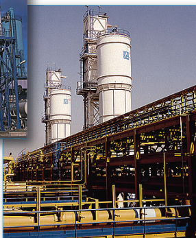
Stockage de gaz
