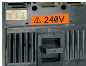
Etiquetas de Peligro Eléctrico
