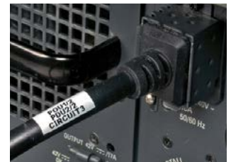
Etiquetado de Infraestructura Eléctrica
