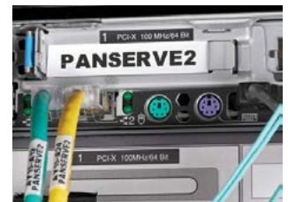
Etiquetado de Infraestructura de Red
