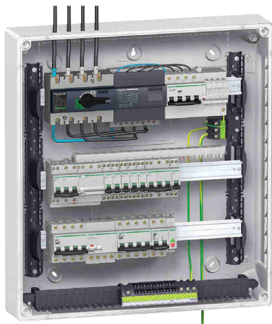
Coffret Pragma Evolution avec arrivée de la terre principale par le bas et parafoudre en haut : un bornier intermédiaire de terre (réf. PRA90053 + PRA90046) est déporté au plus près du parafoudre
