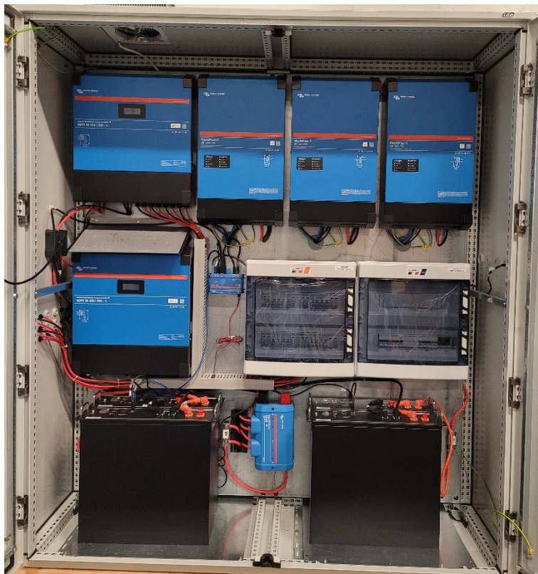
Figure 58 : Modèle 3x5 kVA, 4x3,55 kWh de stockage
