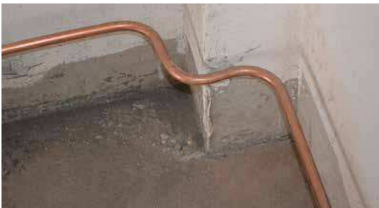
Equipotential grounding conductor
