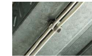
Cables & conduits from metal deck
