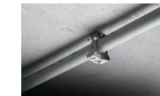
Conduit on concrete
