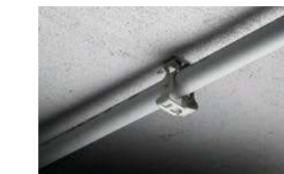
Conduit sur dalle béton
