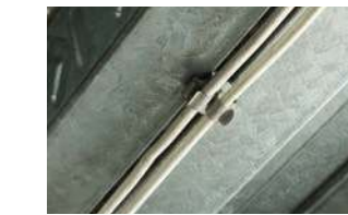
Câbles et conduits sur bac acier
