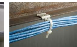
Câbles sur poutre acier
