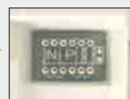
Logement des configureurs
