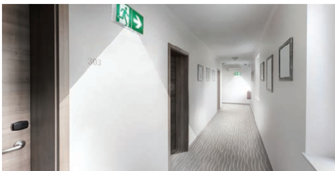
Pose murale : Éclairage couloir
