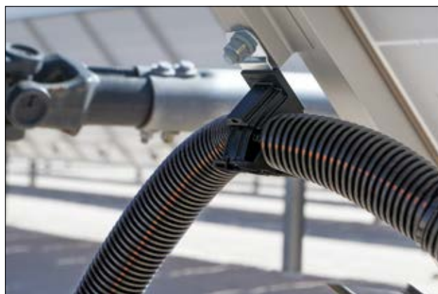
Management de câbles sur installation solaire.
